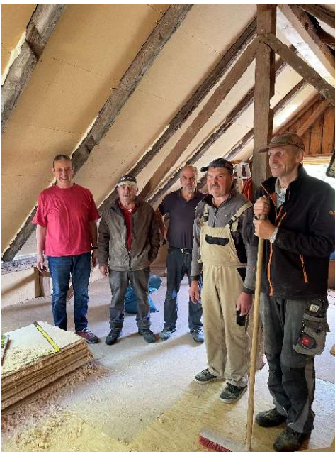
Mitte Juni 2024: Ausbau und Isolierung des Dachs und viele Mitarbeiter werden benötigt: Richard Pentenrieder, Erster Vorstand Sebastian Brunner, Rudi Glas, Josef Lamprecht, Sebastian Vierthaler (von links nach rechts)
