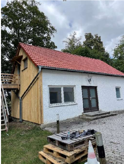
September 2024: Fassade fertiggestellt und das Dach neu eingedeckt von den Mitglieder des KSV Kranzberg und mit tatkräftiger Unterstützung der Mitarbeiter des Bauhof Kranzberg
